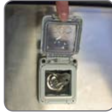
Der Schlüssel-Schalter ist im wasserfesten Kasten platziert.
